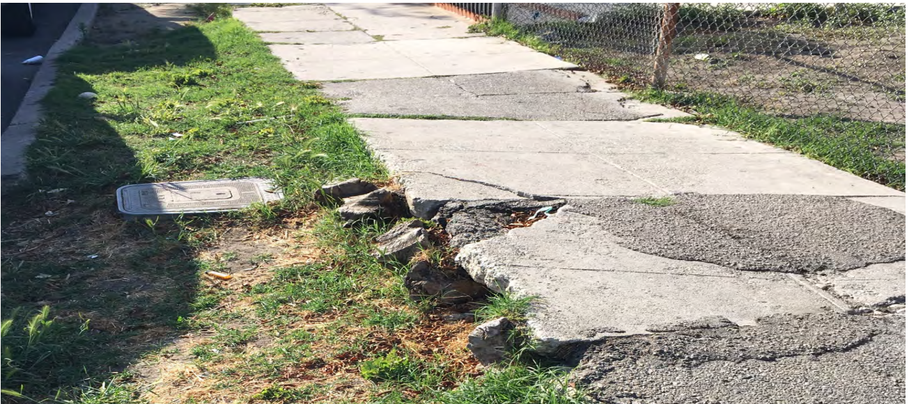
Arriba a la izquierda: Caja subterránea con gran agujero a lo largo de la calle Avenida Central. Arriba a la derecha: Las banquetas estrechas de East Adams Boulevard no proporcionan espacio suficiente para un peatón que utiliza un dispositivo de movilidad asistida y a menudo obligan a los peatones a entrar en el amortiguador de la acera y la calle. Abajo: Banqueta estrecha desnivelada y elevada a lo largo de East Adams Boulevard crear un riesgo de tropiezo.
