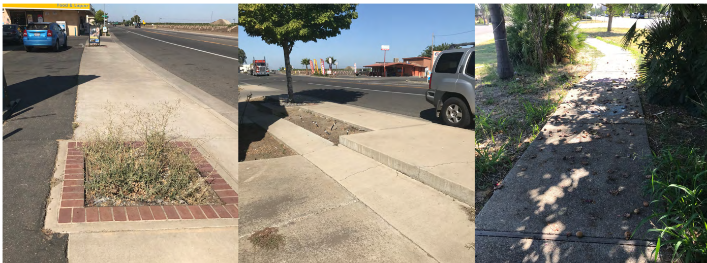
Izquierda: Varios pozos de árboles vacíos sin mantenimiento a lo largo de la Autopista Central Yosemite ocupan la mayor parte del espacio de la banqueta.space. En medio: Una banqueta irregular que conduce a la Farmacia San Joaquín en el lado sur de la Autopista Central Yosemite y la Calle Sutter presenta un peligro de tropiezo para los peatones. Derecha: Escombros en el camino de peatones en Broadway.
