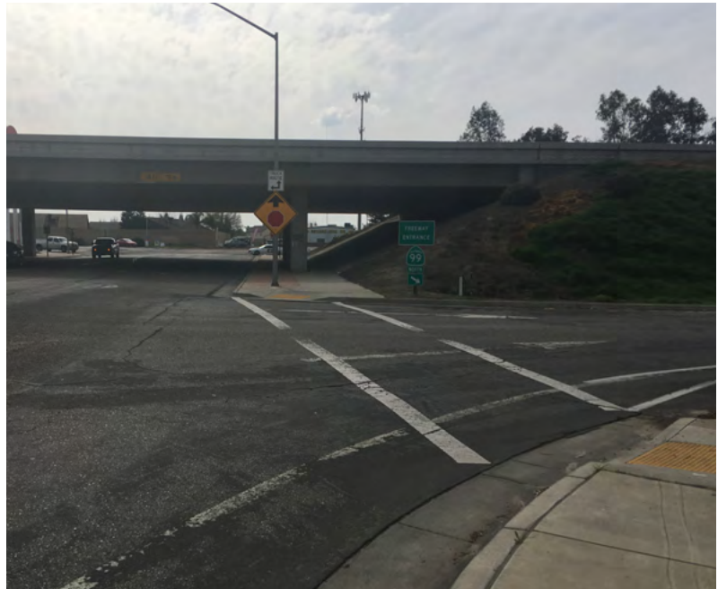
El paso de peatones descolorido en la entrada de la Carretera 99 en la Calle Merced Este.
