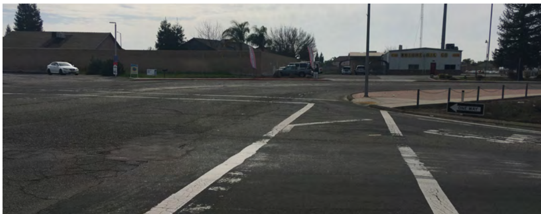
Paso de peatones descoloridos en la salida hacia el sur de la Carretera 99.
